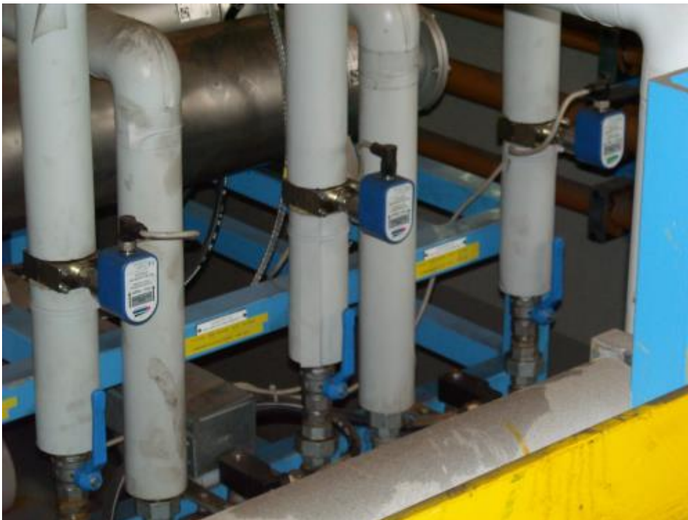
Abbildung 4: Überwachung einer Einfettanlage mit Volumenströmsensoren fluid-Check® und serv-Clip® -2 an einer Durchlaufheizlinie
